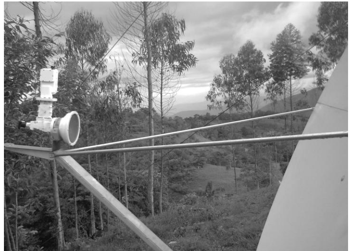
Figura 5: Alimentador y LNB instalado
