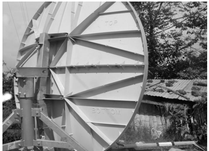
Figura 2: Antena Parabólica Vista posterior
